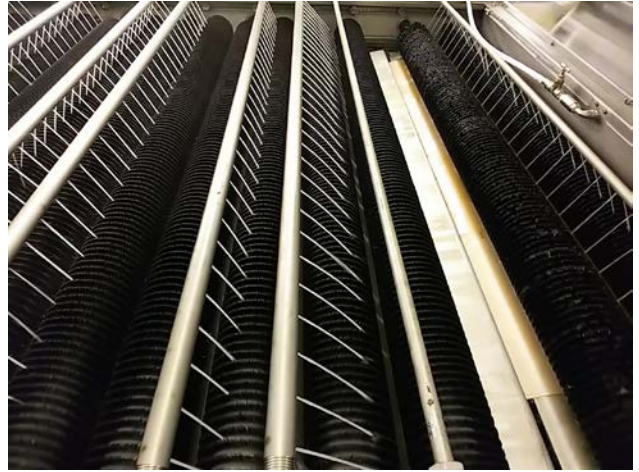
ブラシへの洗浄液供給システム
